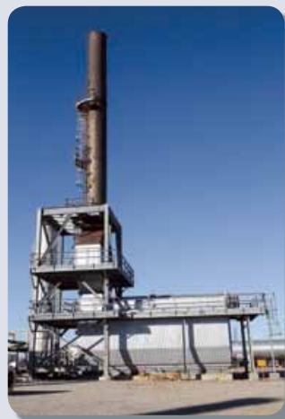
Огневой стенд большой мощности в Центре тестирования ZEECO
